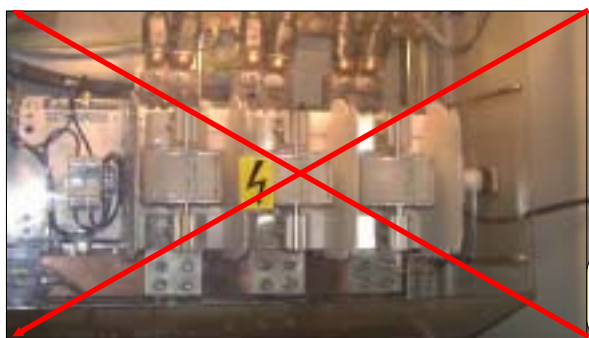
Plexiglass vissé et difficilement démontable en production
